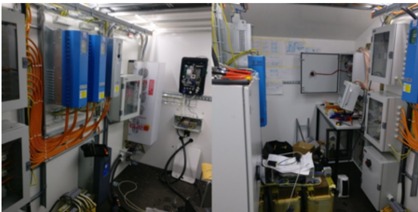
KUVA 2. Energiajärjestelmän sähkötekniistä toteutusta kuvassa 1 esitetyn latausperävaunun sisältä.
